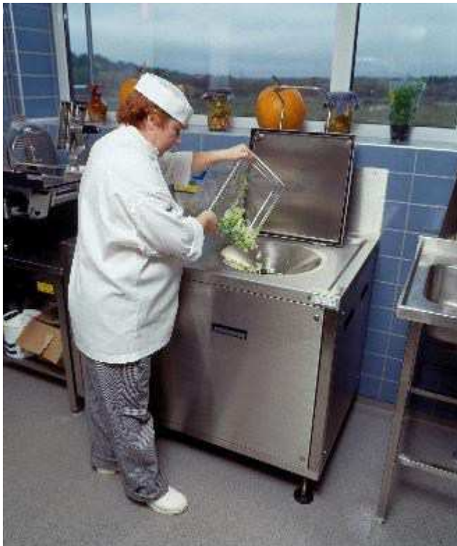
Figur 3. Matavfallskvorn kopplad till en uppsamlingstank.
